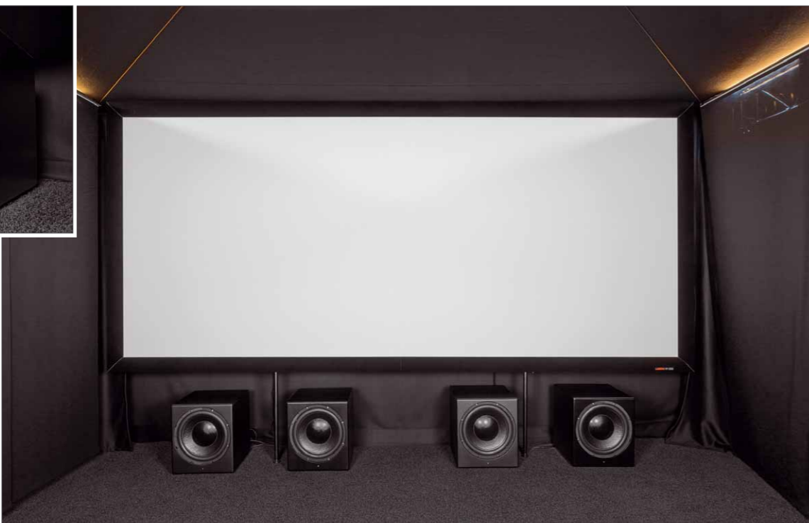
Hinter der vier Meter breiten und 1,70 m hohen Leinwand sind sechs CCRM 12 verbaut, darunter sind die vier Subwoofer SMS G15 aufgereiht. Die schwarzen Oberflächenmaterialien erlauben beste Kontrastwerte beim Bild
